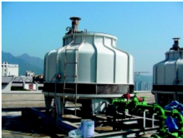
碧秋樓以水冷式冷卻器取代風冷式冷卻器。
