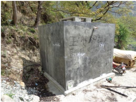
图 3-6 初岗组北边未使用大水池
