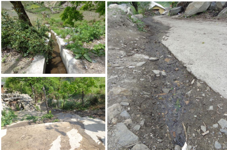
图 2-10 初岗组主排水渠与污水无组织排放现象
