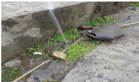
图 2-8 乱拉水管与漏水现象
