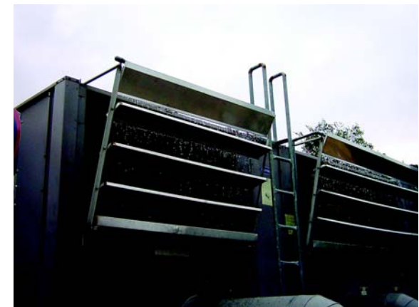
Evaporative Cooling System in SFARSC 上海總會科研技術中心的蒸發式水冷系統
