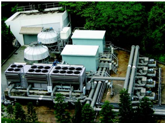
Replacement by Water-Cooled Chillers in SFARSC 上海總會科研技術中心更換水冷式冷卻器
